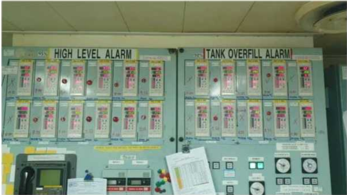
Gambar: Cargo Control Room MT. RAYONG CHEMI Sumber: Dokumen MT. RAYONG CHEMI
